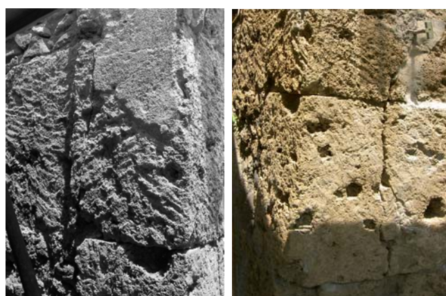
Figura 18. Officina coactiliaria o bottega dei feltrai (Regio IX, VII,1): conci del paramento che presentano fenomeni di fessurazione.
